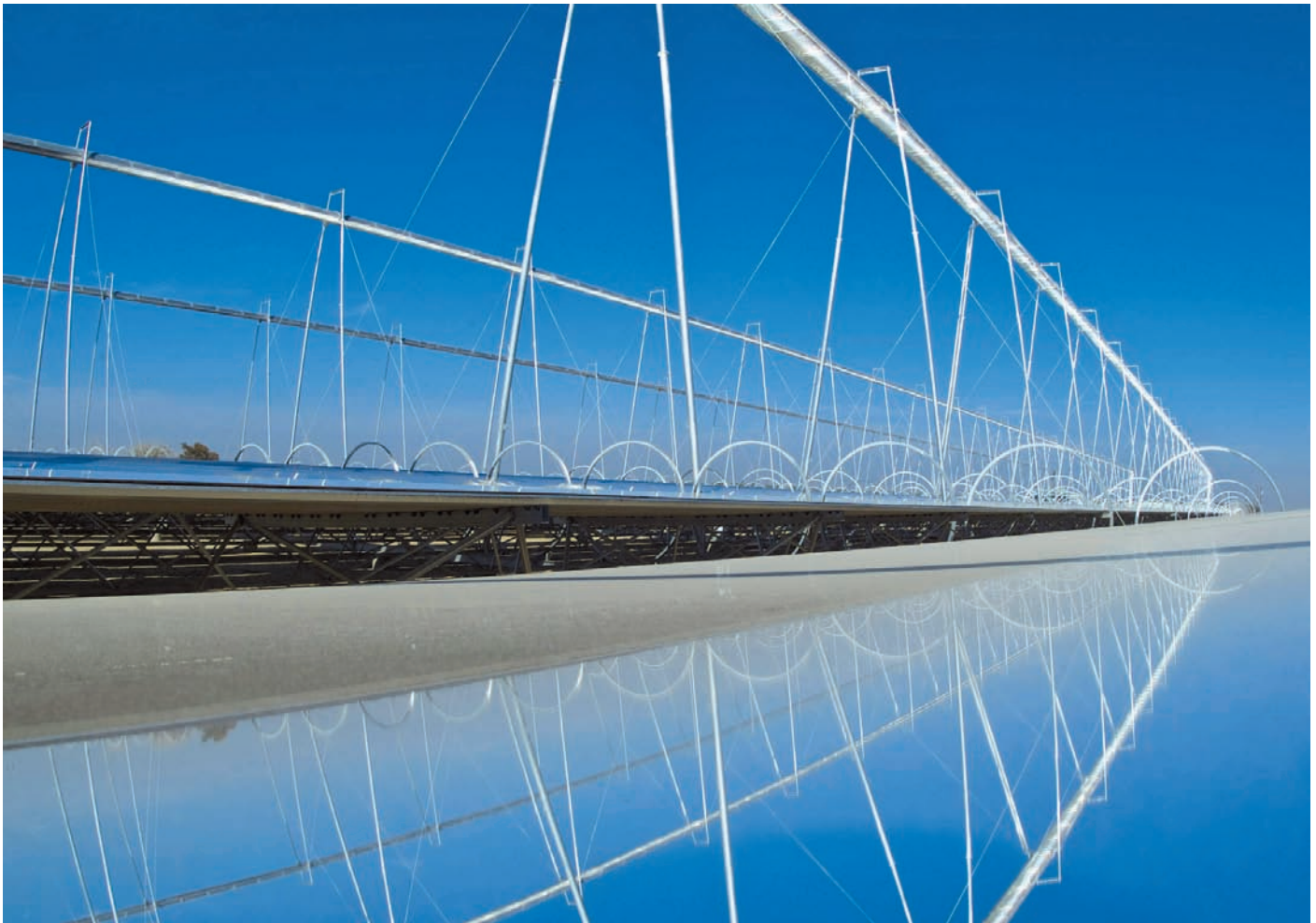
L'impianto solare termoelettrico di Kimberlina inaugurato il 23 ottobre 2008 a Bakersfield, California. Si tratta del primo impianto di questo tipo al mondo della potenza di 5 MWe.
