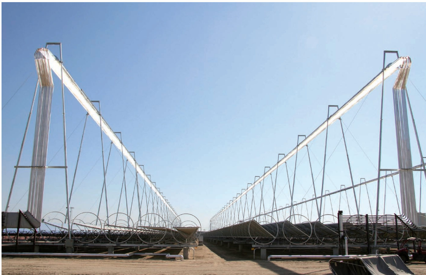
Fig. 10. Primo piano di due campi specchi dell'impianto solare termoelettrico di Kimberlina.
