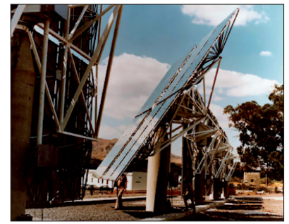
Fig. 4 – Eurelios – Eliostati tipo francese CETHEL installati su piedistallo in cemento (foto 1980 cortesia Museo dell'Industria e del Lavoro di Brescia)
