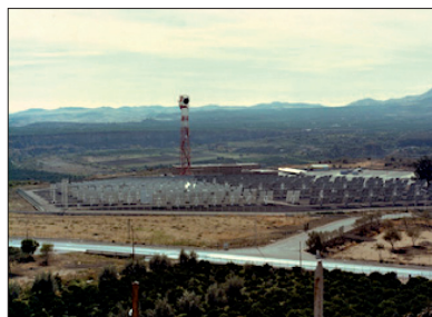
Fig. 2 – L'impianto Eurelios entrato in esercizio ad Adrano (Catania) nella primavera del 1981. Vista del campo specchi e della torre con la caldaia sulla sommità (foto cortesia G. Parodi)
