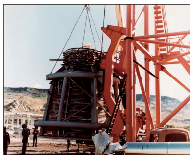
Fig. 3 – Eurelios – La caldaia solare al momento dell'installazione sulla cima della torre (foto 1980 cortesia Museo dell'Industria e del Lavoro di Brescia)
